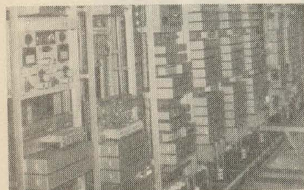
電報電話局機械室
